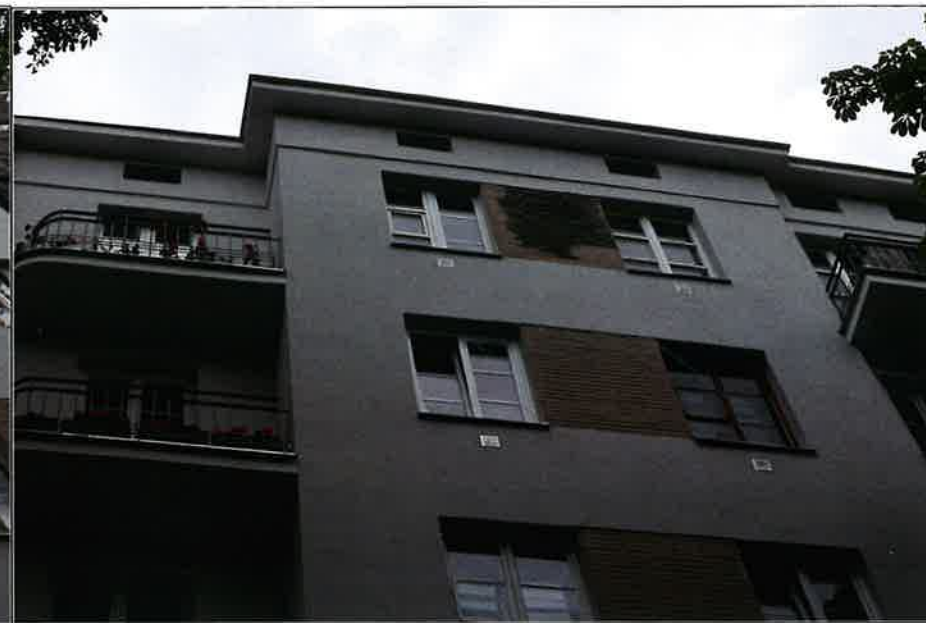
Widok ostatnich kondygnacji oraz zamknięcia przez okap (uszkodzenie partii ceglanej przez postrzał?).
